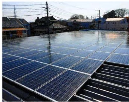
石井造園の屋根に敷かれた太陽光パネル
